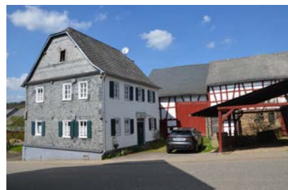
Alternative Lösungen: PV-Anlagen in Ziegelfarbe oder (unten) auf einem Carport.
